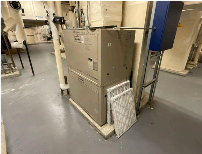
13 - FAN COIL UNIT
